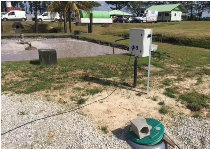
Armoire électrique et poste de relevage
